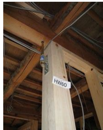
左上柱頭固定金物
