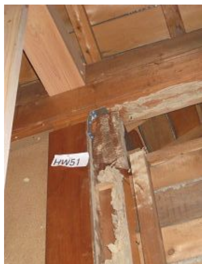
左上柱頭固定金物
