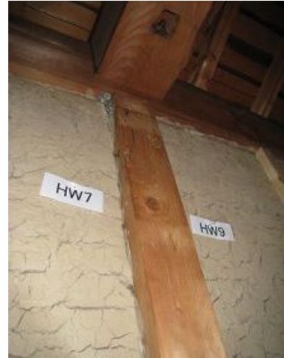
左上柱頭固定金物
