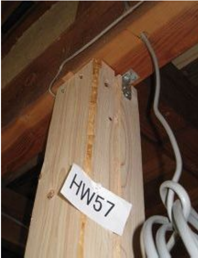
左上柱頭固定金物
