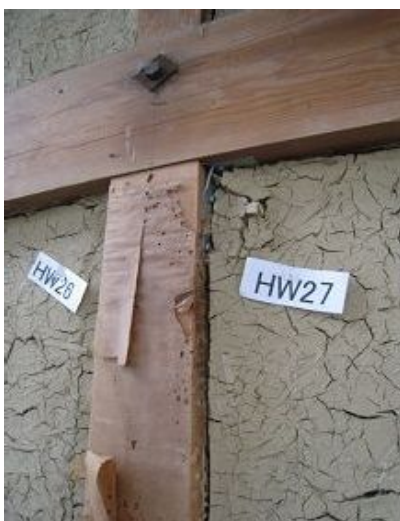
左上柱頭固定金物
