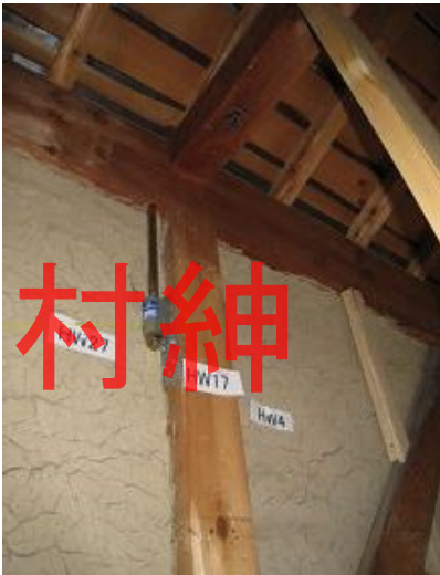
左上柱頭固定金物
