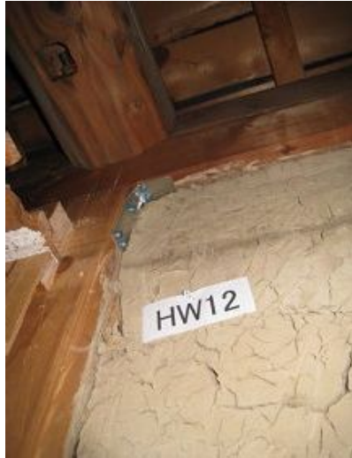
左上柱頭固定金物
