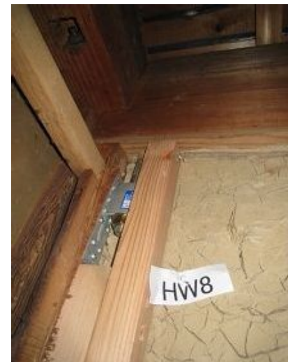
左上柱頭固定金物
