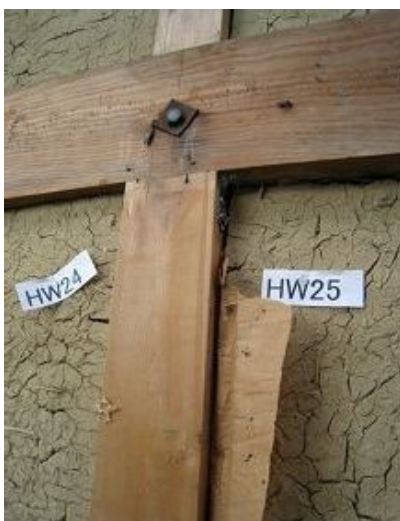
左上柱頭固定金物
