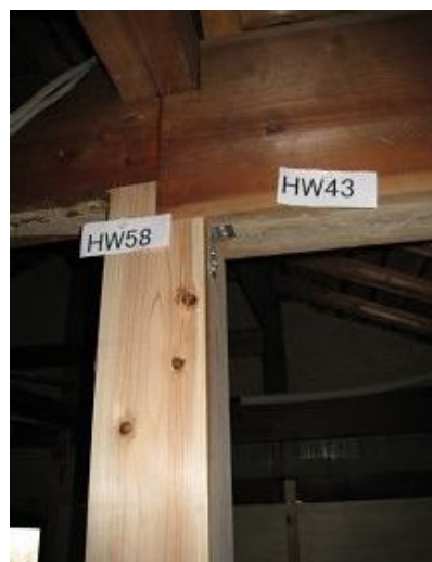
左上柱頭固定金物
