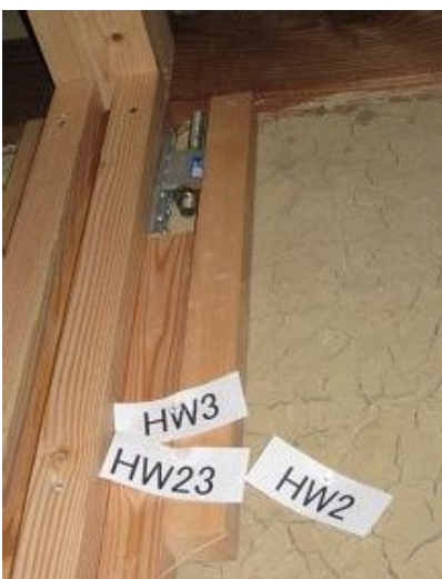
左上柱頭固定金物
