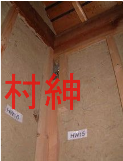
左上柱頭固定金物
