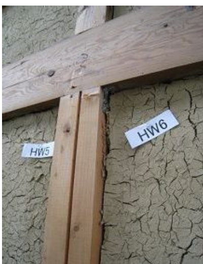
左上柱頭固定金物
