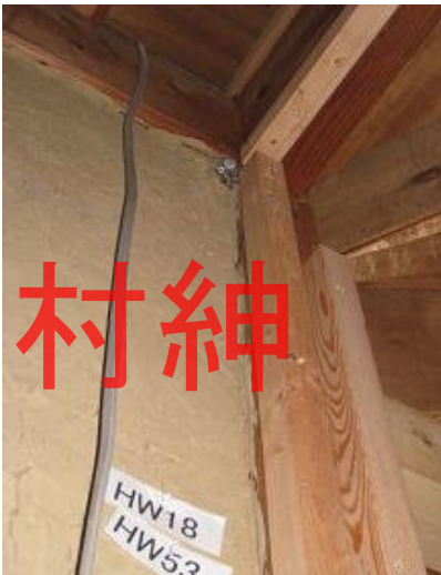
左上柱頭固定金物
