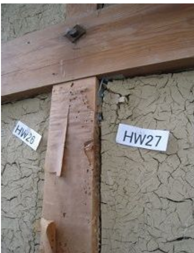
左上柱頭固定金物
