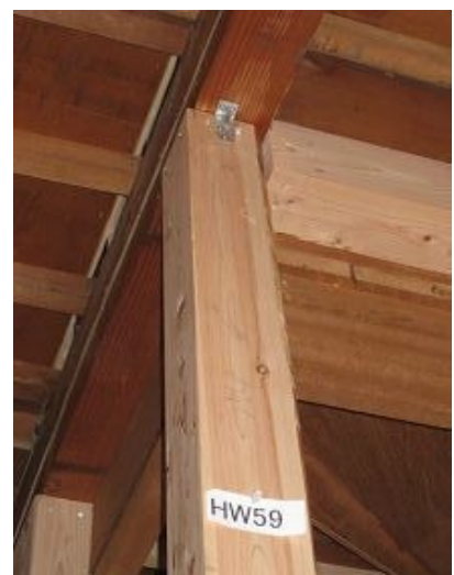
左上柱頭固定金物
