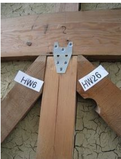
左上柱頭固定金物
