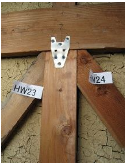
左上柱頭固定金物
