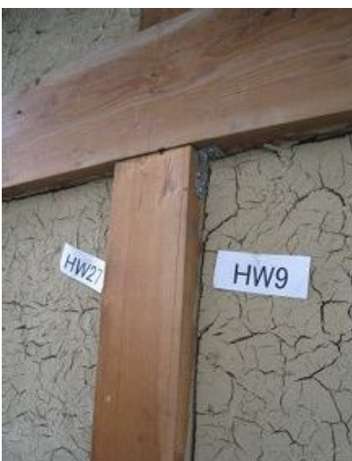
左上柱頭固定金物
