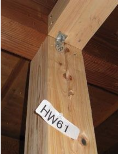
左上柱頭固定金物
