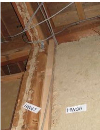
左上柱頭固定金物
