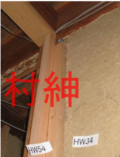
左上柱頭固定金物
