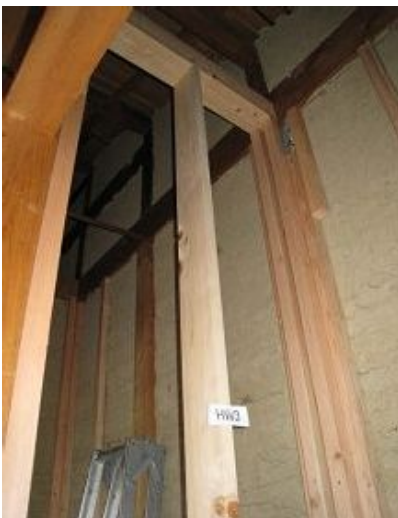
左上通し柱のため金物無し
