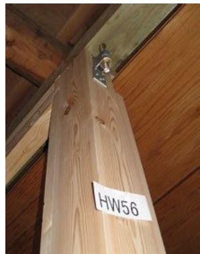
左上柱頭固定金物
