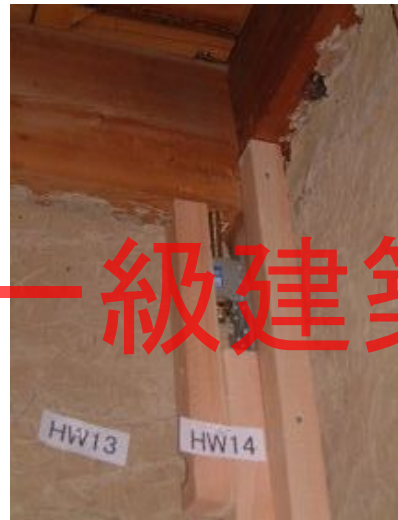
左上柱頭固定金物
