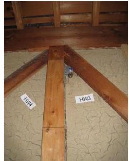
左上柱頭固定金物
