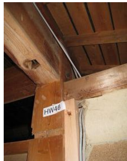
左上柱頭固定金物
