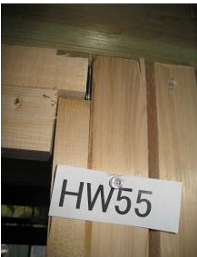
左上柱頭固定金物
