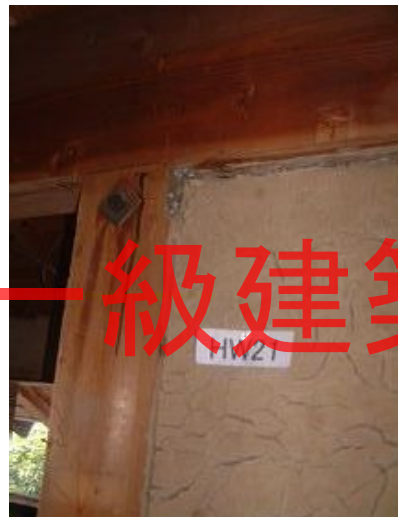
左上柱頭固定金物
