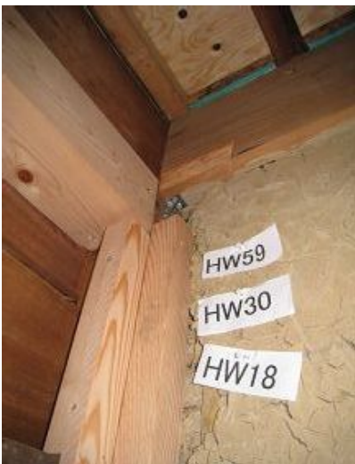
左上柱頭固定金物
