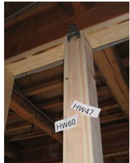
左上柱頭固定金物
