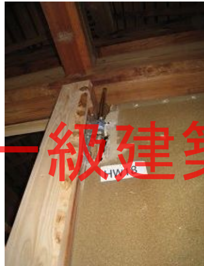
左上柱頭固定金物
