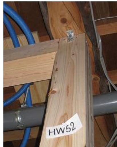
左上柱頭固定金物
