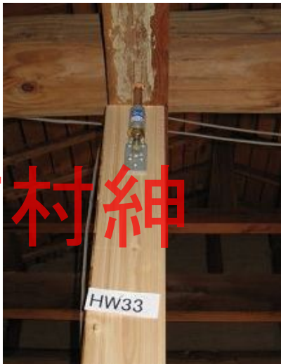
左上柱頭固定金物
