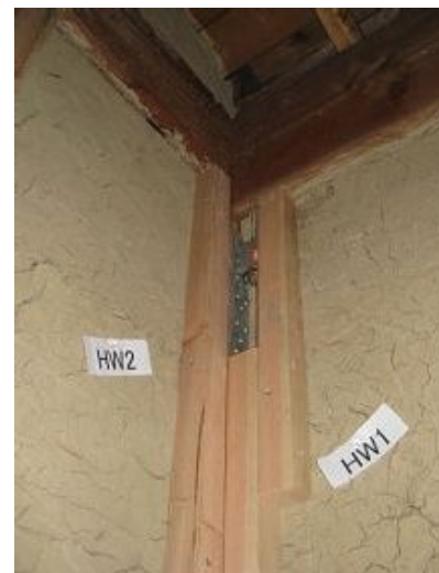
左上柱頭固定金物
