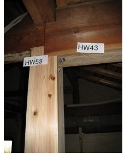
左上柱頭固定金物
