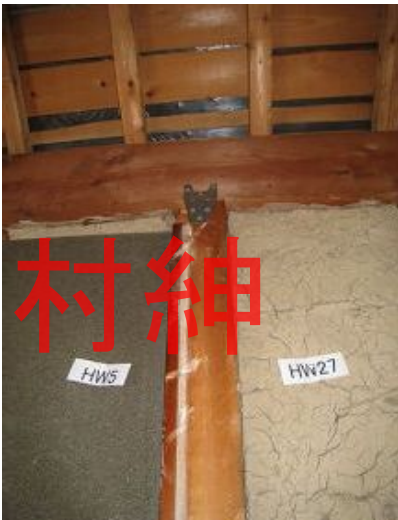
左上柱頭固定金物
