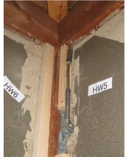
左上柱頭固定金物
