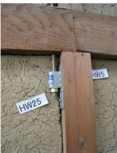
左上柱頭固定金物
