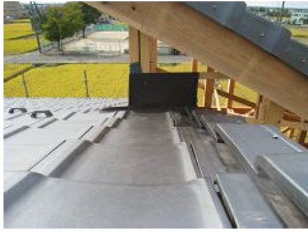
谷部分板金確認 ※防水層の立ち上がり不足のため手直し指示
