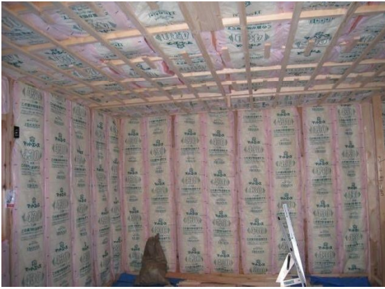
壁・天井断熱材:グラスウール t=100\text{mm}
